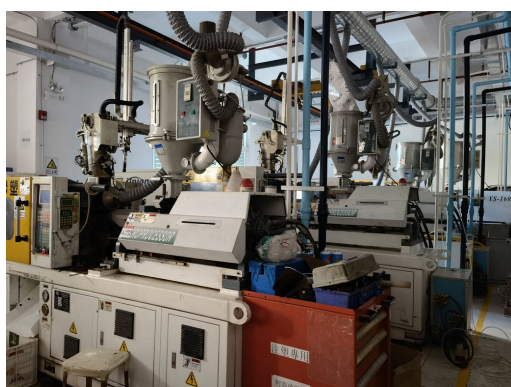
注塑废气收集措施
