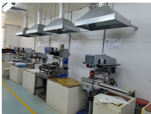
移印废气收集措施
