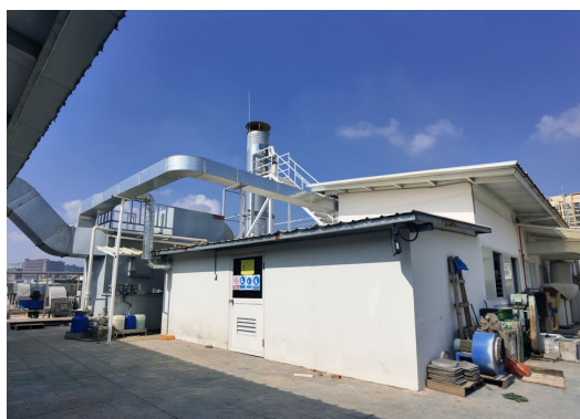
喷漆废气处理设施
